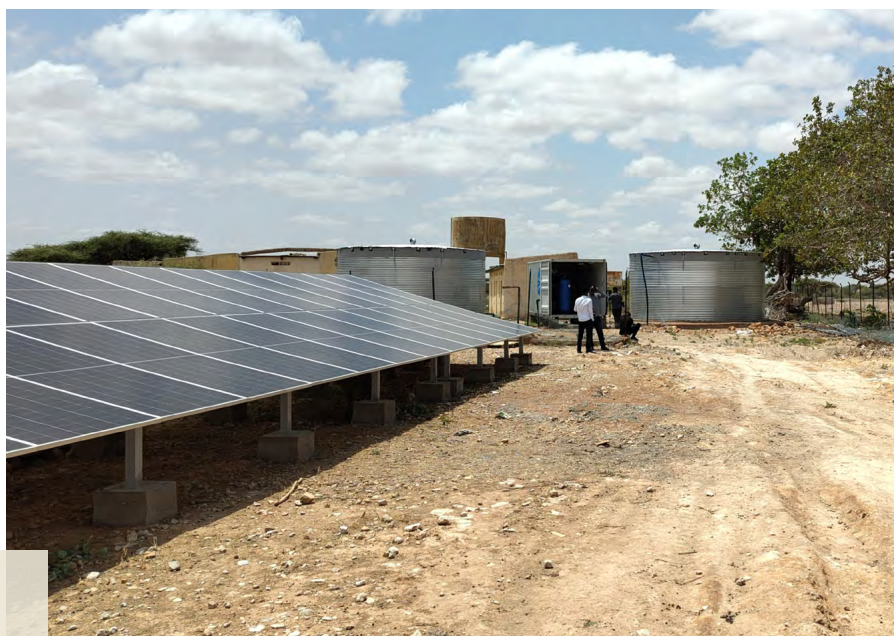
Solarpaneele sichern eine nachhaltige Stromversorgung der Entsalzungsanlagen, die Oxfam in Somaliland errichtet.
